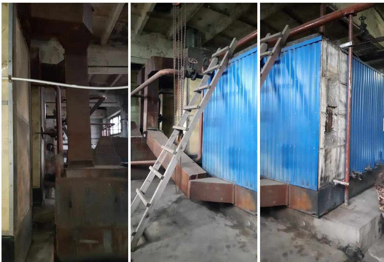
Рисунок 9. Задняя часть и тракт уходящих газов котлоагрегатов №№1-3 котельной №5 п. Мысовой
