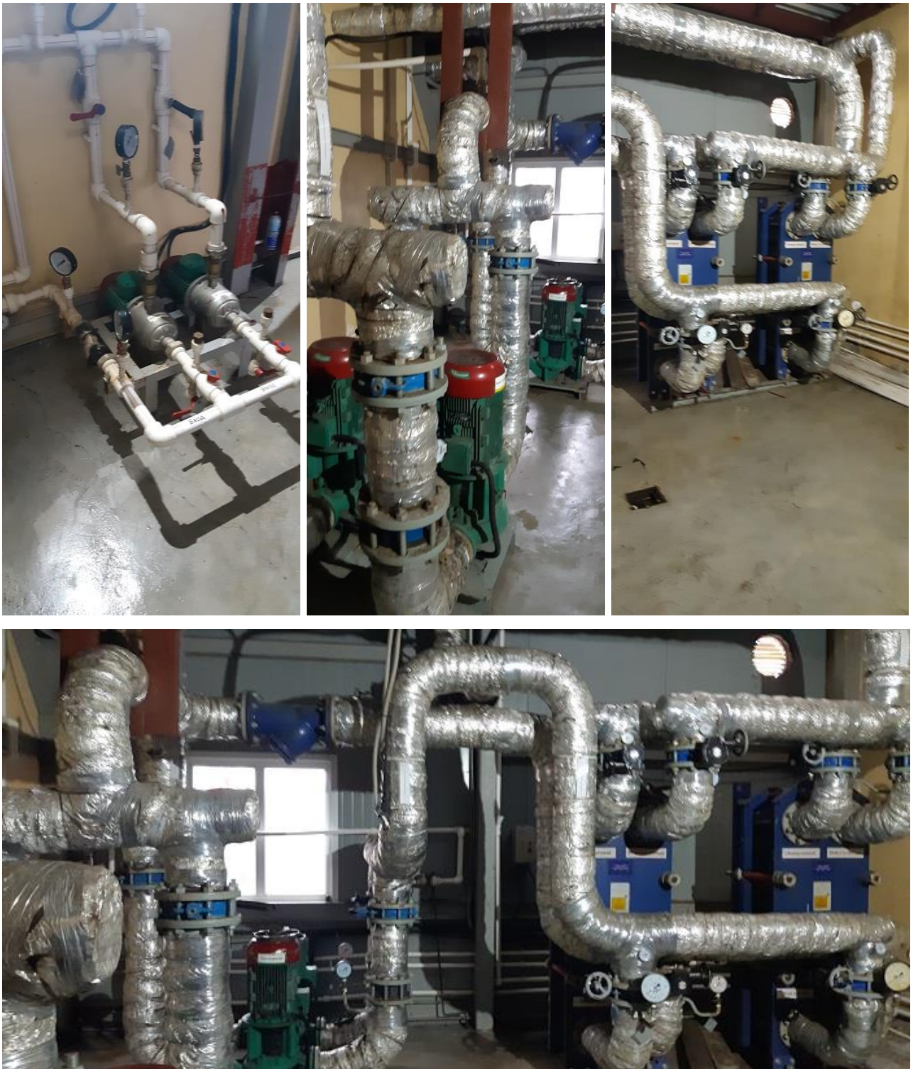
Рисунок 11. Насосное и теплообменное оборудование котельной №4
