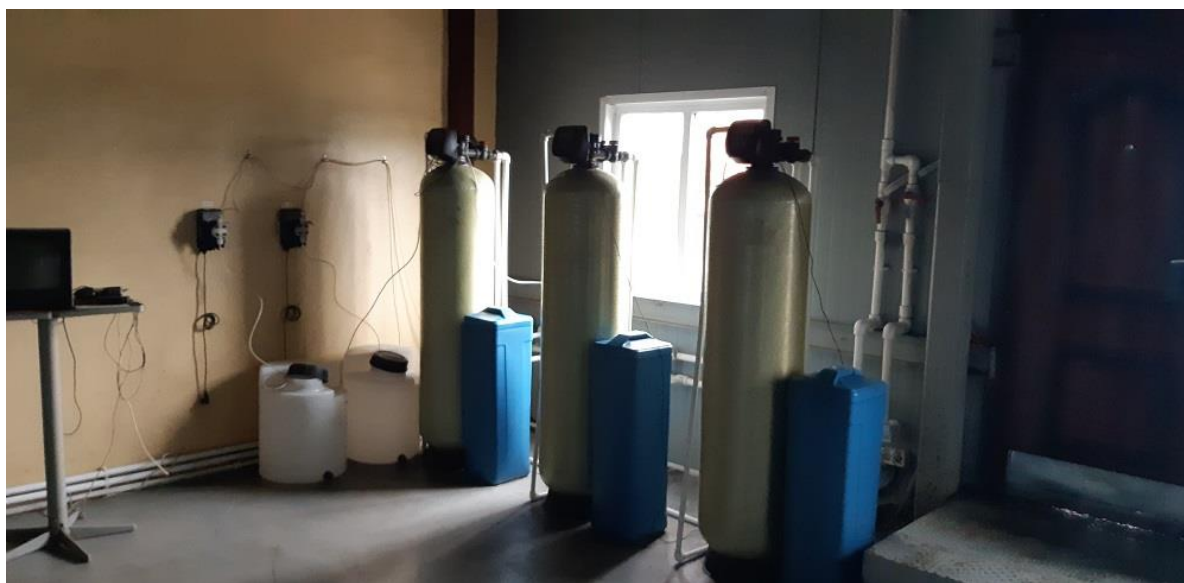
Рисунок 27. Установки умягчения воды котельной №4
