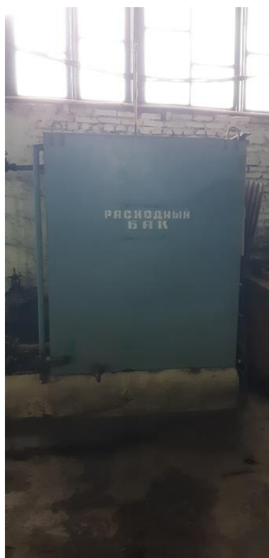
Рисунок 28. Расходный бак запаса исходной воды
