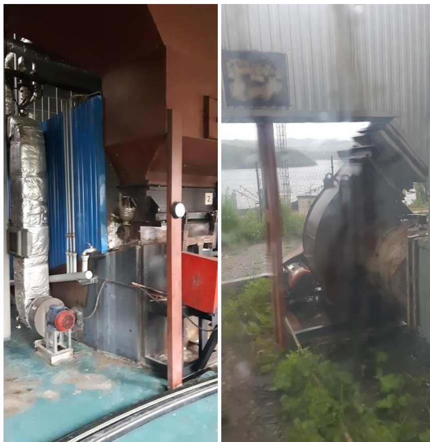
Рисунок 12. Тягодутьевое оборудование котельной №4
