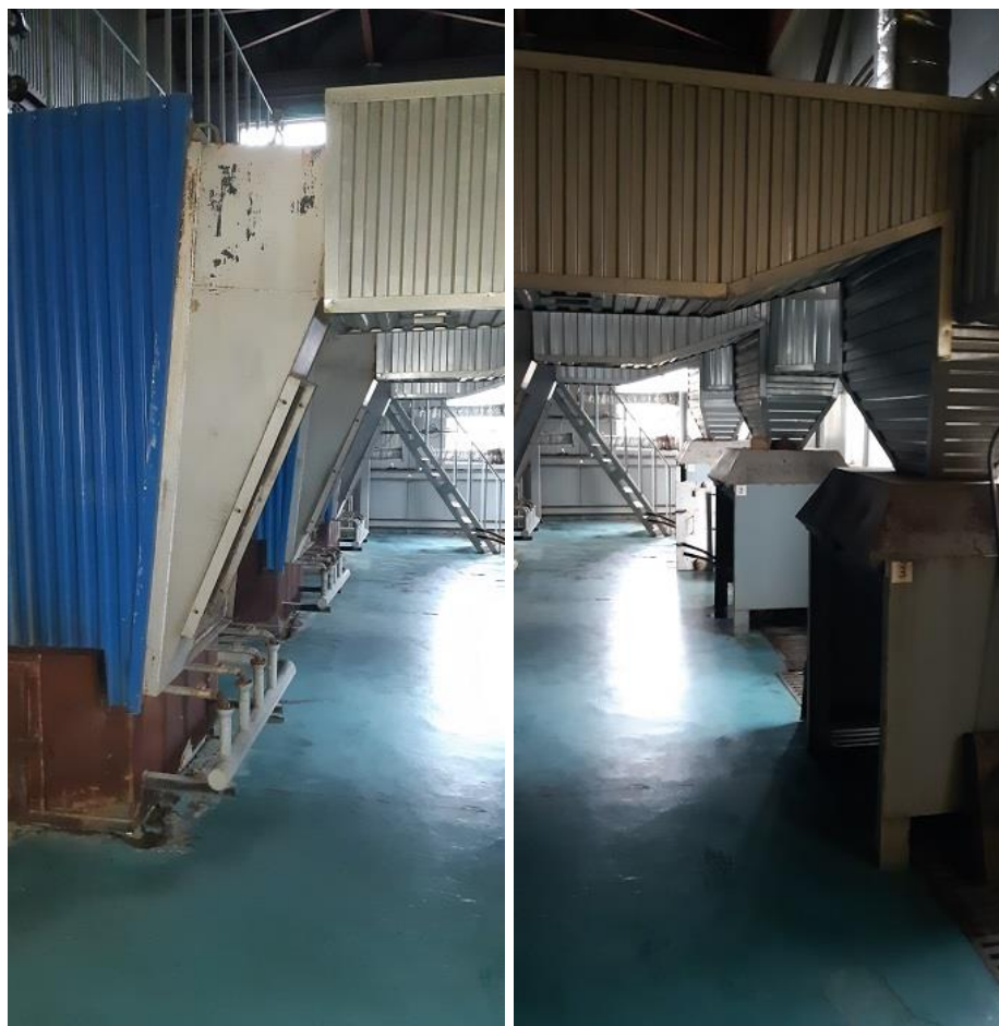
Рисунок 7. Задняя часть и тракт уходящих газов котлоагрегатов №№1-3 котельной №4 п. Подъяпольское
