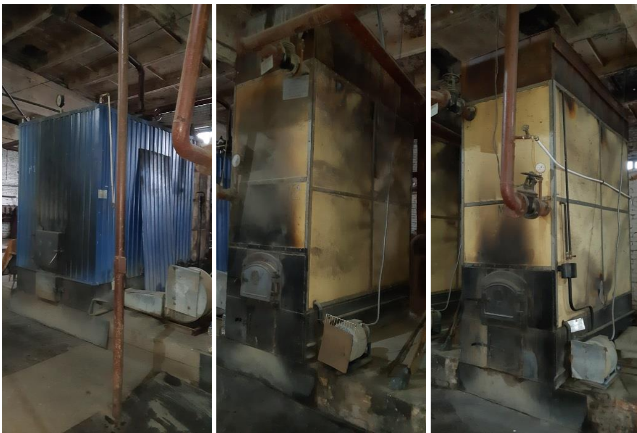
Рисунок 8. Внешний вид котлоагрегатов №№1-3 котельной №5
