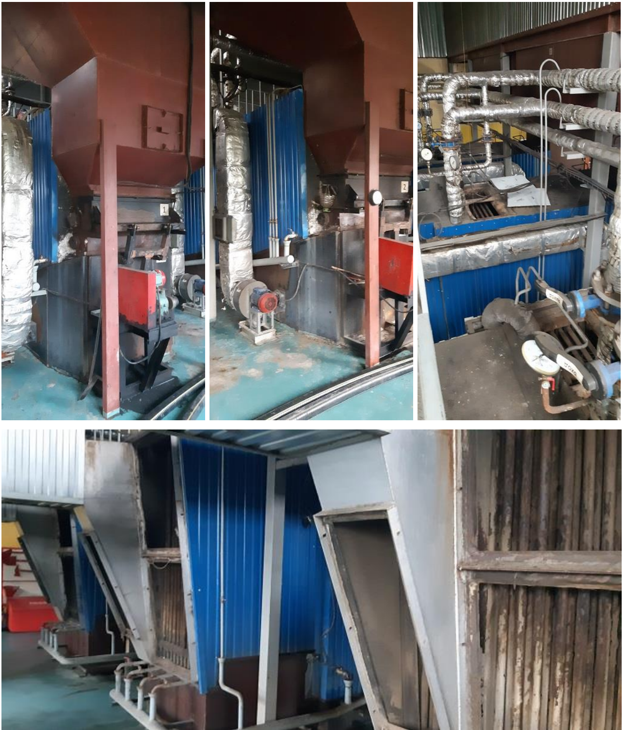
Рисунок 6. Внешний вид котлоагрегатов №№1-3 котельной №4
