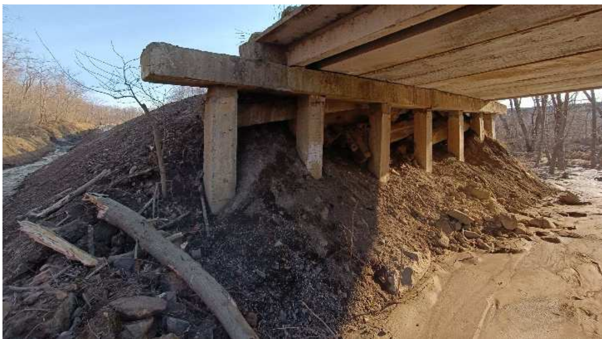
Рис.4.5. Вид на левую опору старого мостового перехода через ручей 1. Слева на заднем плане заметен подход к мосту канавы (МВС-1)
