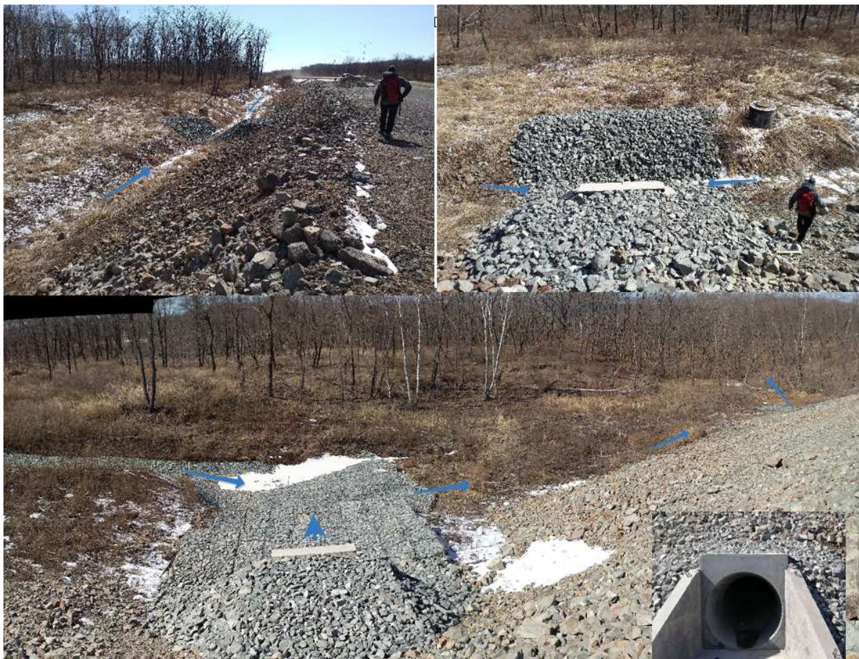
Рис.4.16. Водопропуск через автодорогу на ПК117+22. Вверху – на верховой стороне а/д насыпи, внизу – на низовой стороне, внизу справа – водопропускное отверстие
