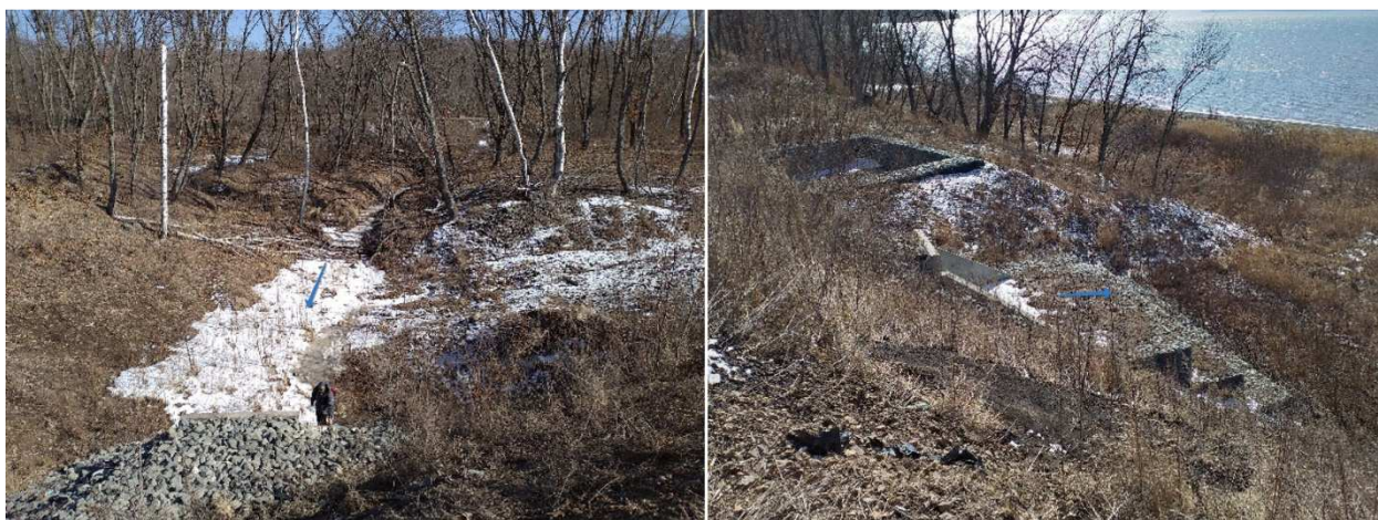
Рис.4.11. Долина ручья 2 непосредственно выше и ниже конструкции водопропуска через а/д «Владивосток-Находка-порт Восточный»
