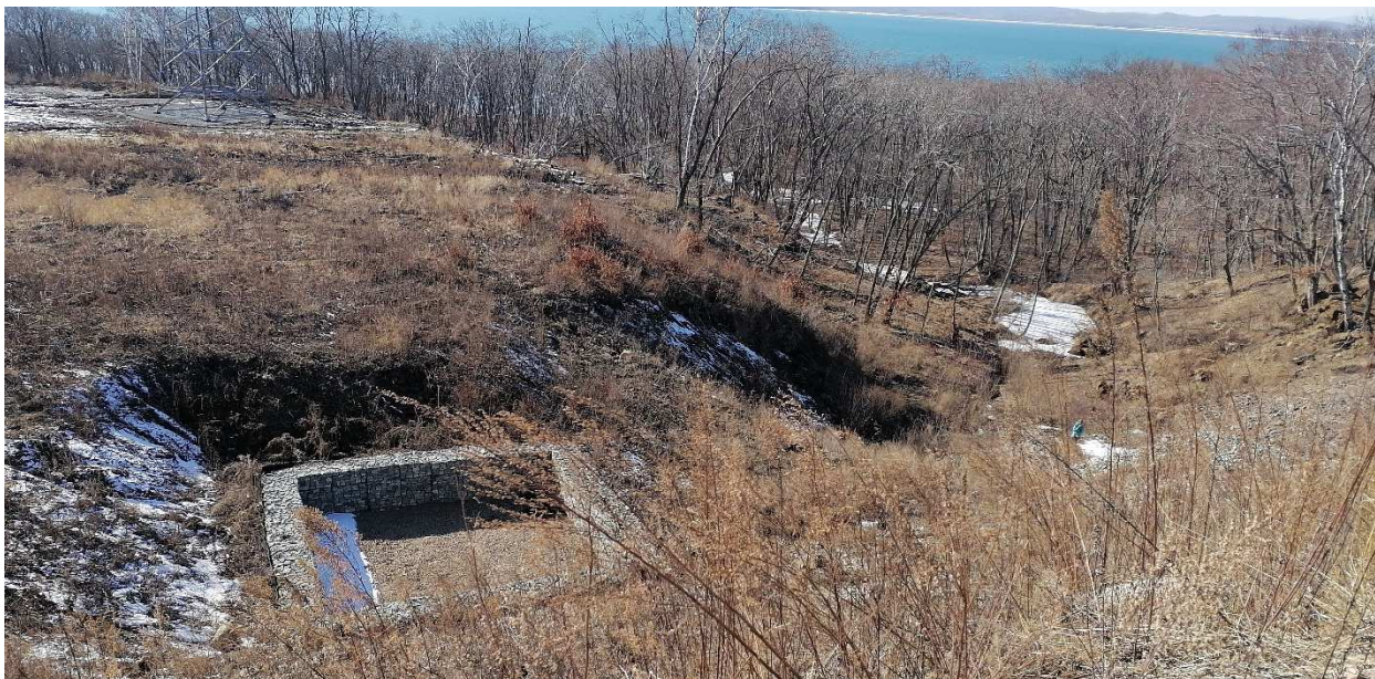
Рис.4.14. Врез ручья 5 ниже водопропуска
