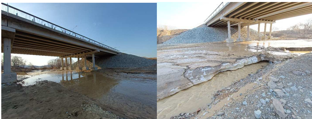
Рис. 4.3. Вид на ручей 1 под мостовом переходом с верхней (слева) и нижней (справа) стороны а/д «Владивосток-Находка-порт Восточный»
